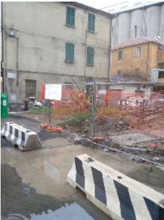
FOTO 3 INSUFFICIENTE DECORO URBANO CANTIERE LATO MONTE
