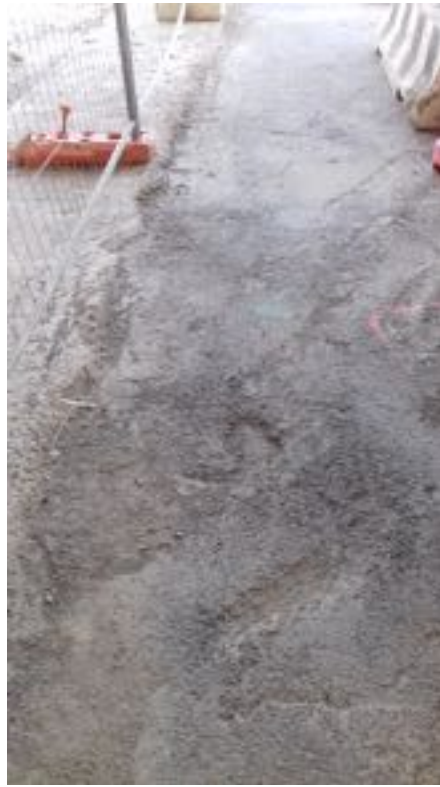
FOTO 2 IL FONDO IN CASO DI PIOGGIA VIA AURELIA
